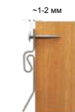
Монтаж панелей без антиураганного замка (D4D, D5C). "Шуршит" при сильном ветре.
